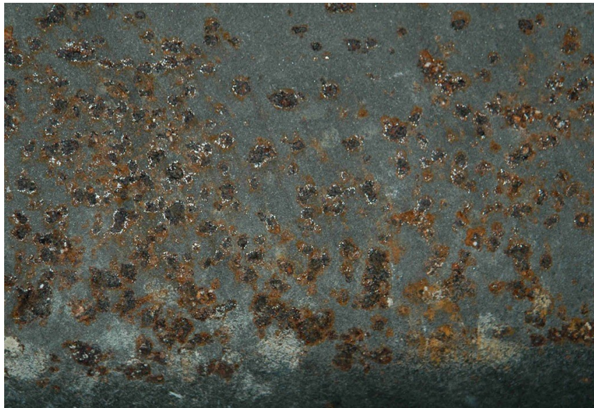
Slika 8. Pitting korozija čelika u morskoj vodi [13]
