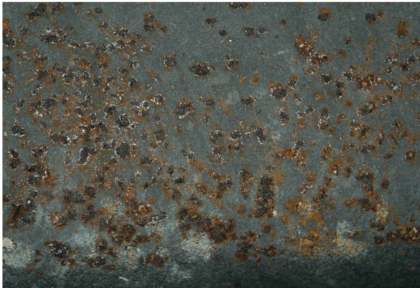
Slika 8. Pitting korozija čelika u morskoj vodi [13]
