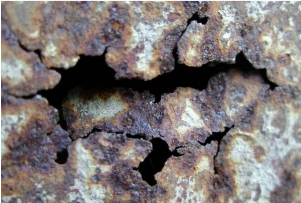
Slika 3. Kemijska korozija metala [6]
