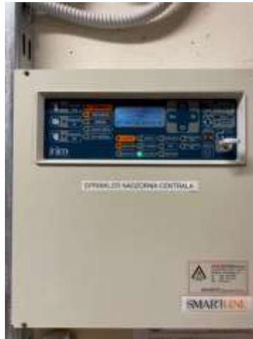
Slika 15. Sprinkler nadzorna centrala
