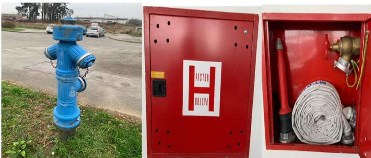
Slika 22. Unutarnji i vanjski hidrant
