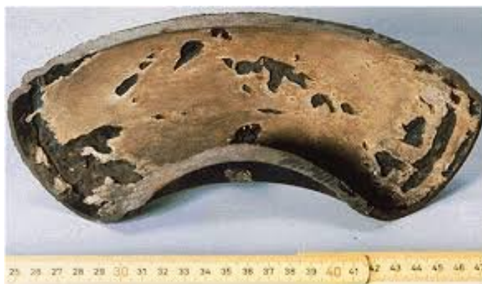
Slika 54. Erozijska korozija cijevi [108]
