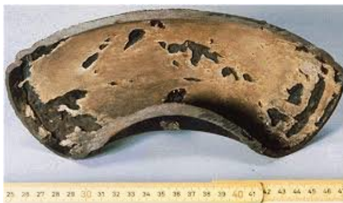
Slika 54. Erozijska korozija cijevi [108]
