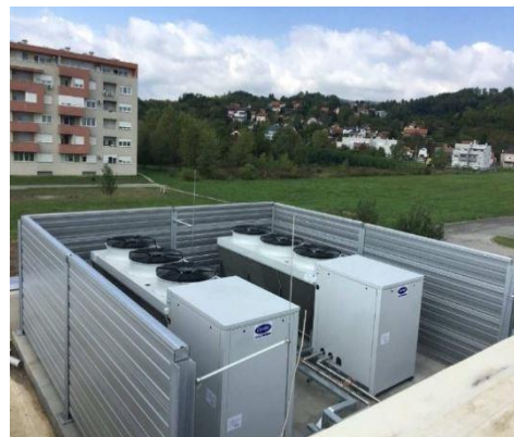
d) zaštitna barijera na dizalicama topline i rashladnim sustavima
