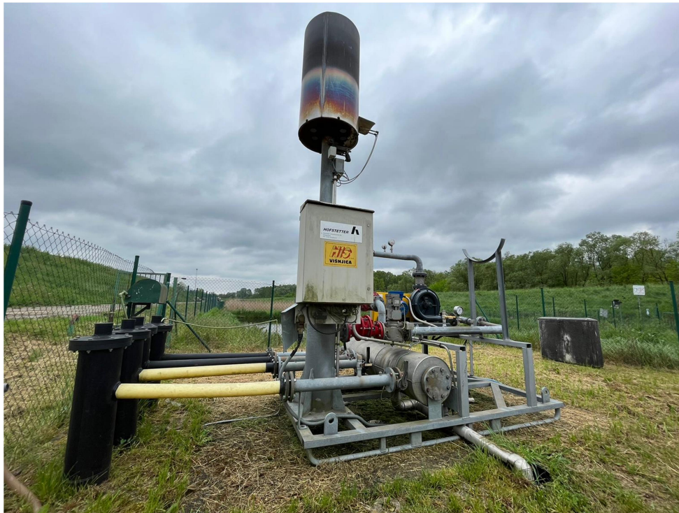
Slika 14. Plinsko- crpna stanica za spaljivanje odlagališnog plina
