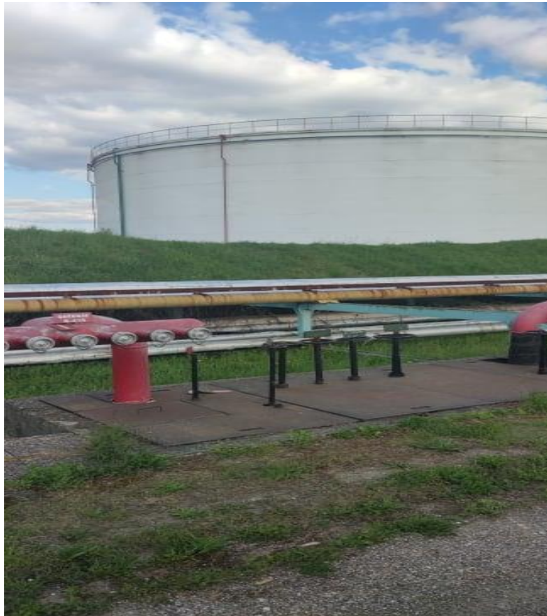
Slika 6. Sustav za hlađenje raspršenom vodom na spremniku
