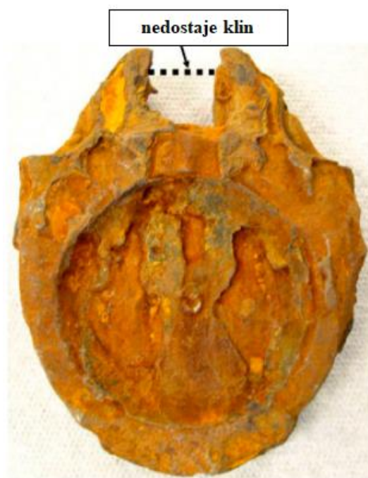
Slika 3. Opća korozija zasuna [8]
