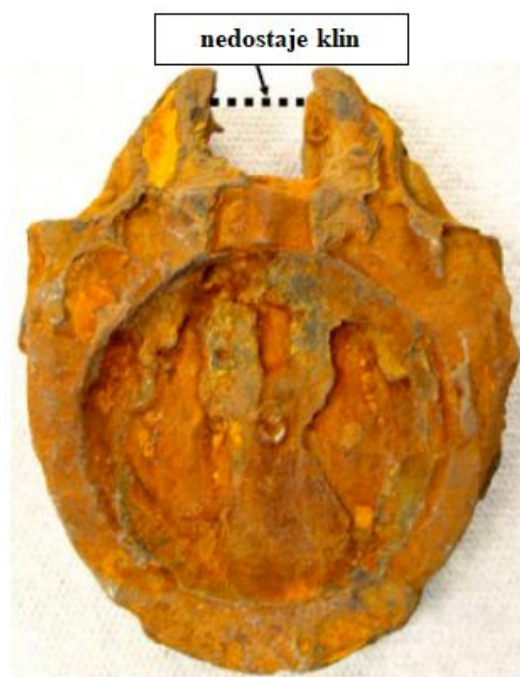
Slika 3. Opća korozija zasuna [8]
