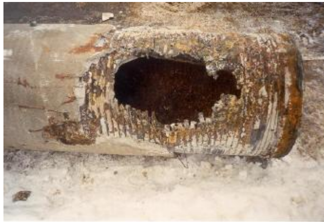
Slika 10. Oštećenja zbog korozije u tlu [14]
