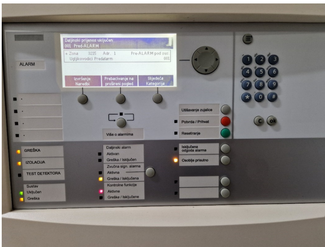
Slika 7. Digitalna nadogradnja javljača požara sa sustavima pre-alarma
