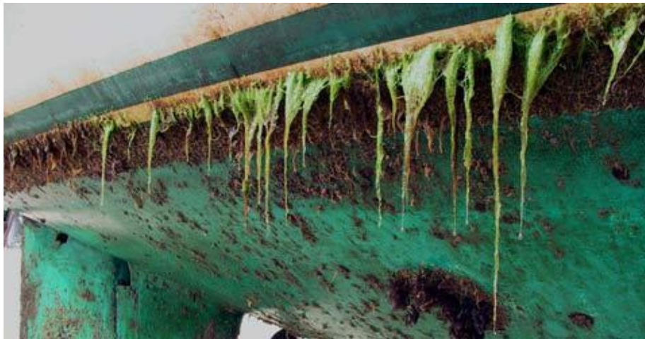
Slika 15. Primjer biokorozije na brodu i obraštaj organizmima [20]
