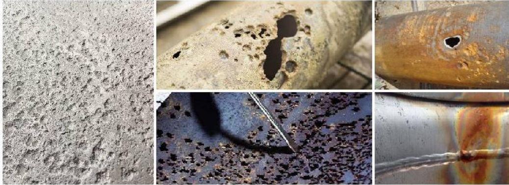
Slika 10. Primjeri rupičaste korozije na cijevima, ravnim metalnim površinama te na zavarenim spojevima [17]
