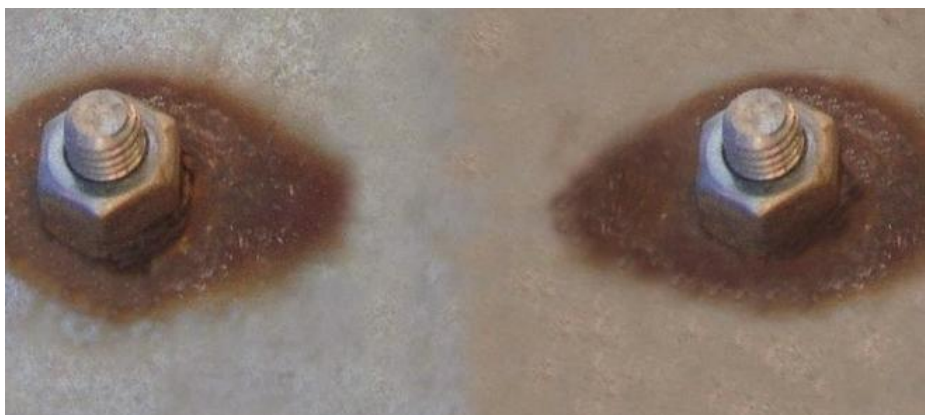
Slika 11. Primjer galvanske korozije, spoj vijka i matice [18]
