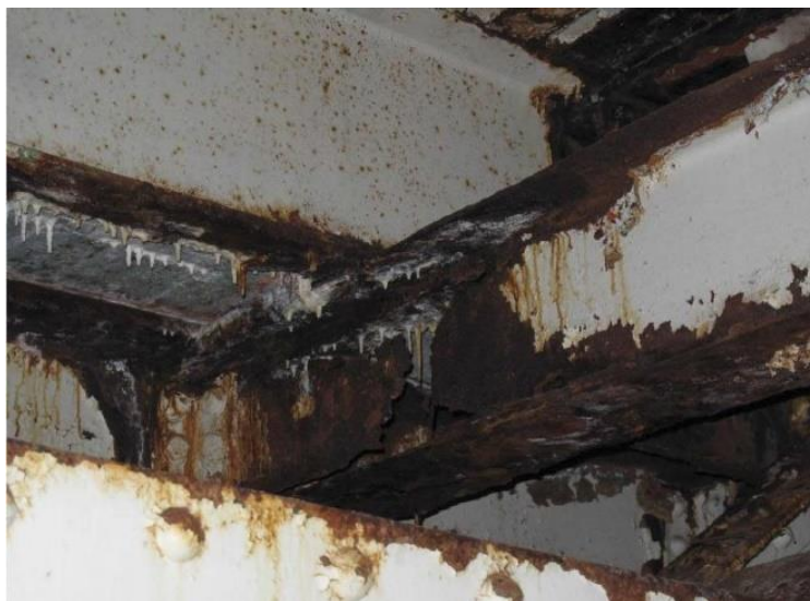
Slika 14. Korozija u procijepu čelične konstrukcije mosta [18]
