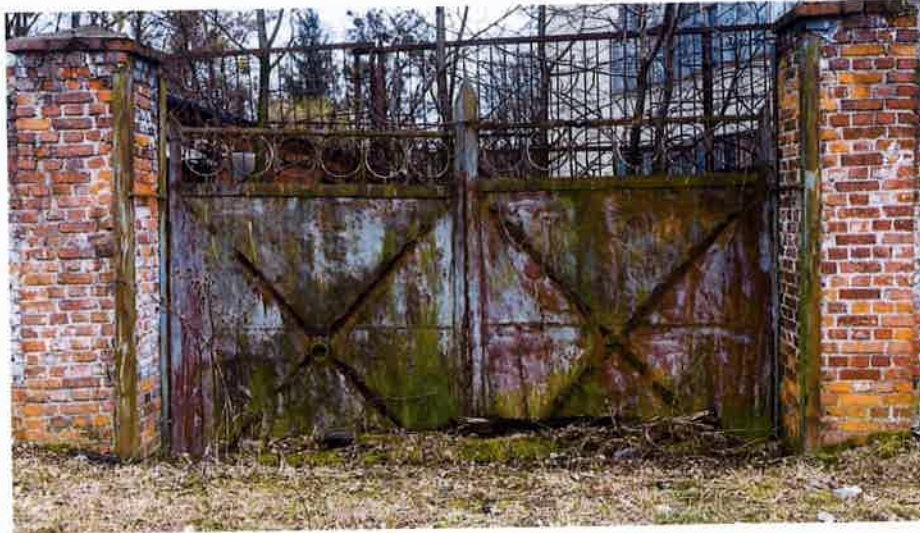
Slika 8. Primjer djelovanja atmosfertske korozije na ogradi [19]
