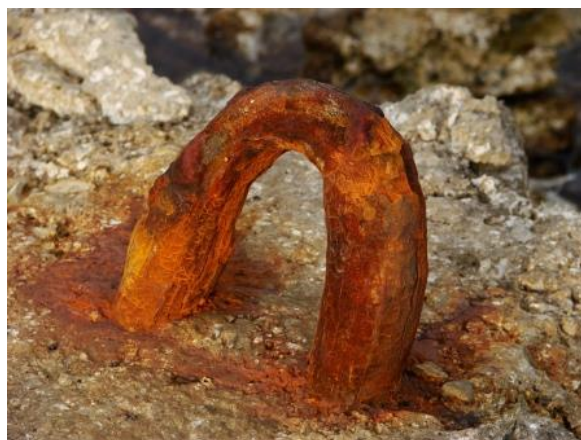
Slika 1. Primjer kemijske korozije metala [2]
