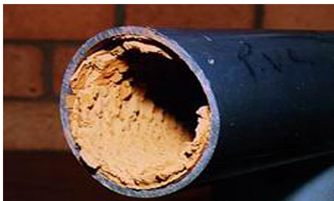
Slika 3. Cijev s nataloženim kamencem [11]
