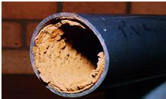
Slika 3. Cijev s nataloženim kamencem [11]
