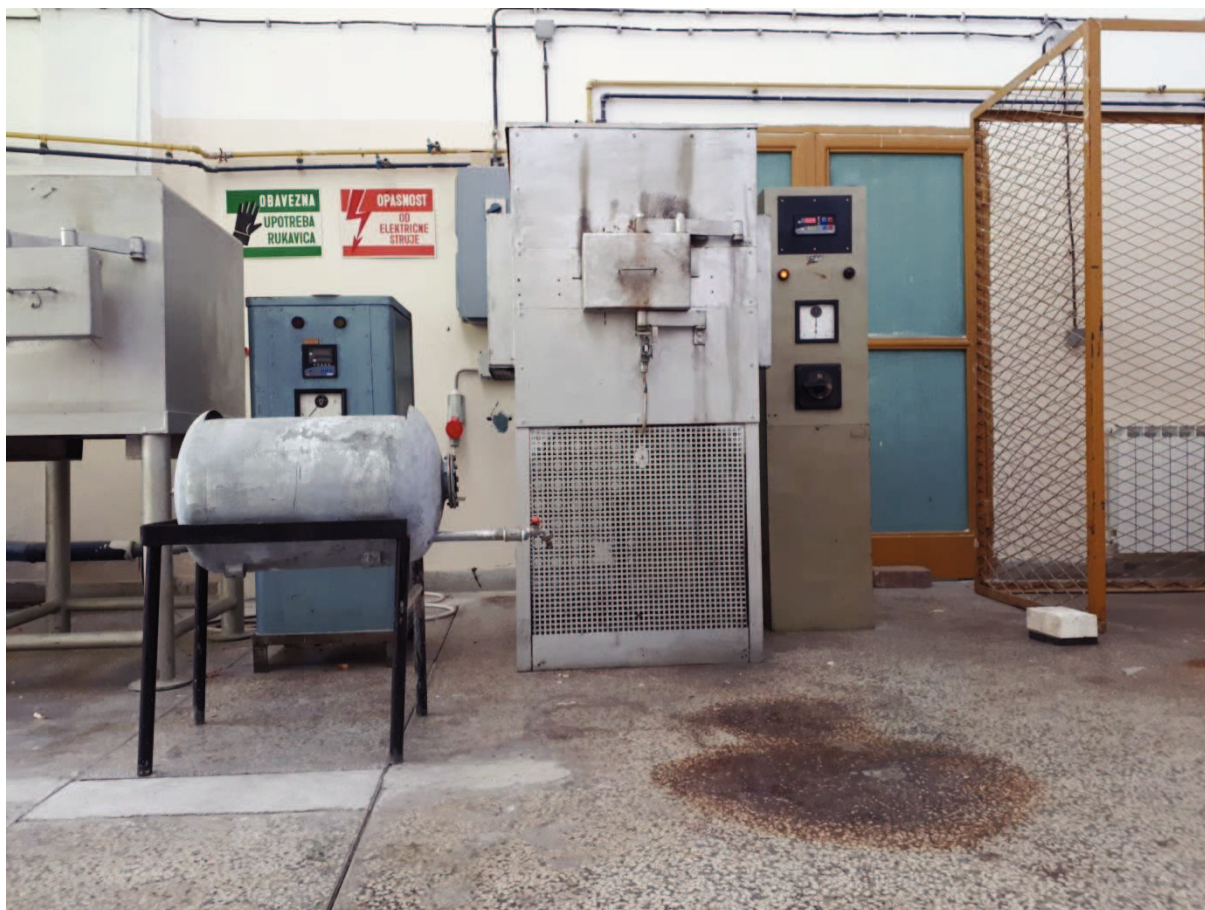
Slika 32. Fotografija elektrootporne komorne peći za žarenje
