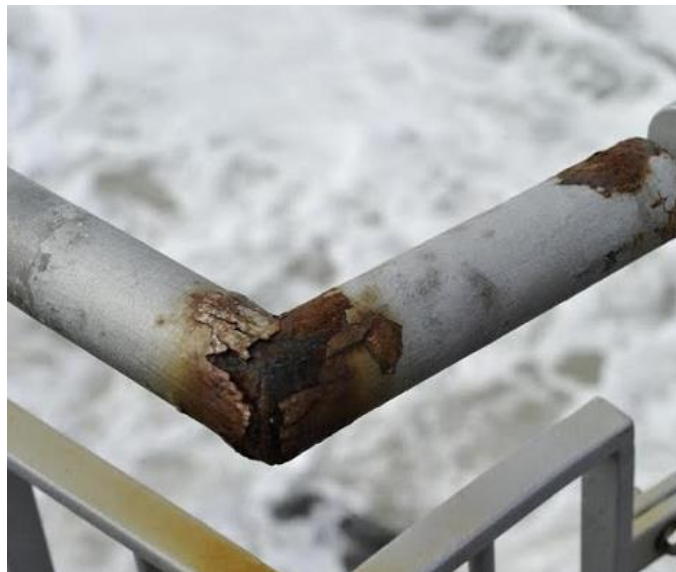
Slika 10. Primjer čelične ograde zahvaćene atmosferskom korozijom [19]
