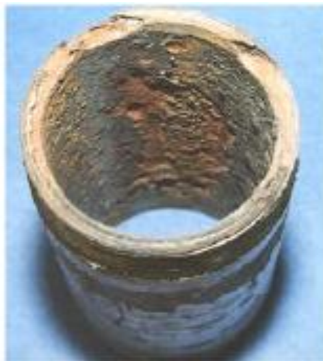
Slika 12. Primjer rupičaste korozije [13]
