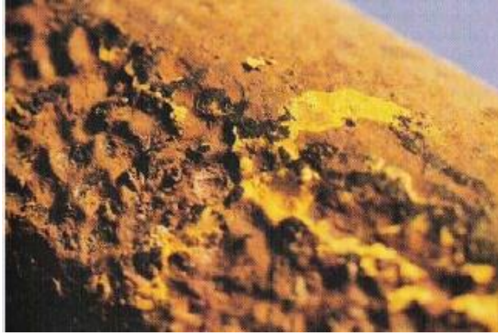
Slika 3. Primjer visokotemperaturne kemijske (plinske) korozije na vanjskoj stijenci pregrijačke cijevi parnog kotla [7]
