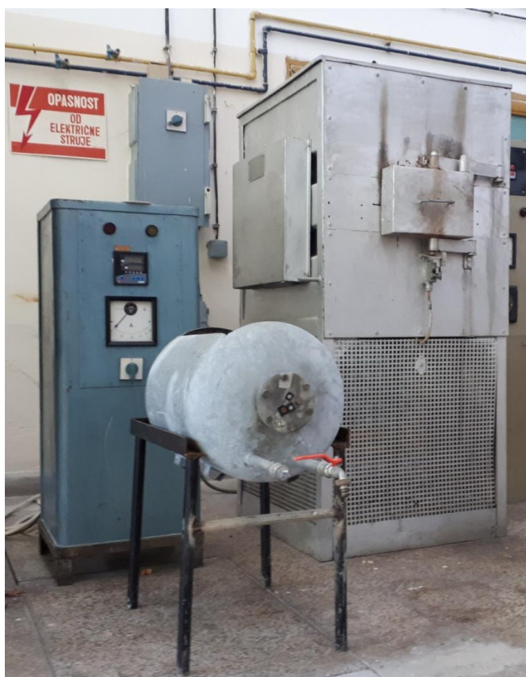
Slika 30. Fotografija elektrootporne komorne peći za žarenje
