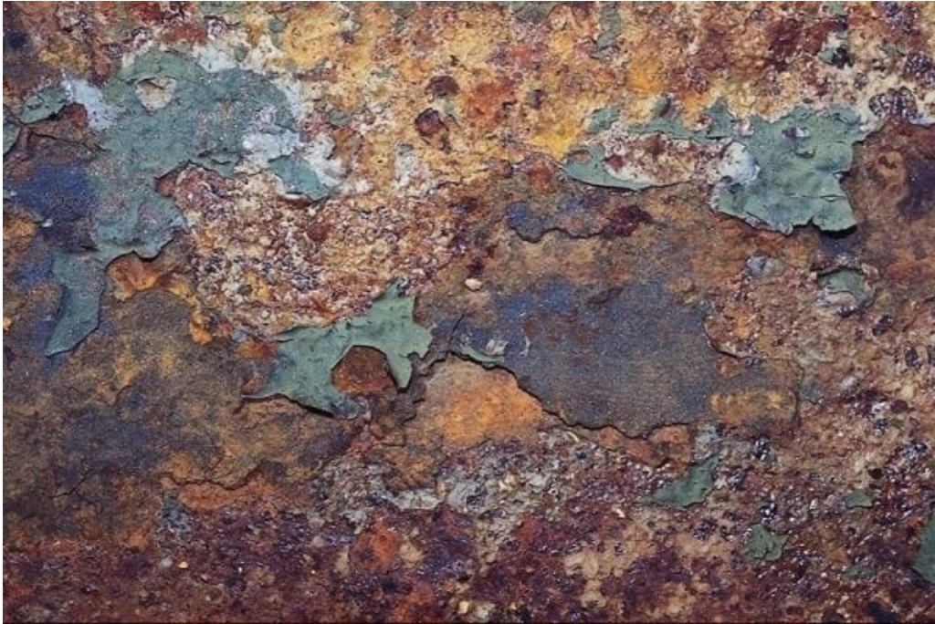
Slika 4. Elektrokemijska korozija čelika [8]
