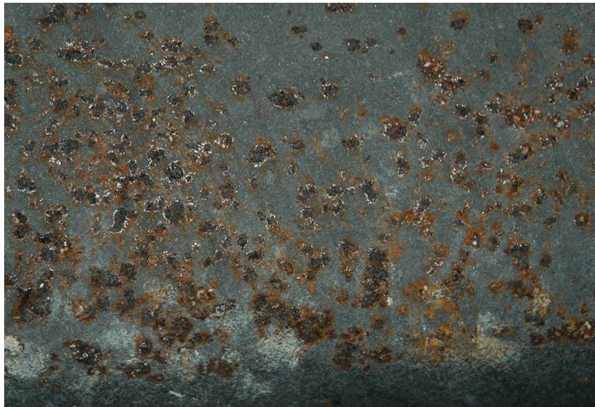
Slika 8. Pitting korozija čelika u morskoj vodi [13]
