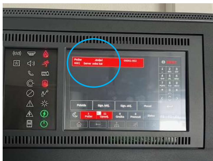
Slika 32. Vatrodojavna centrala signalizira požar
