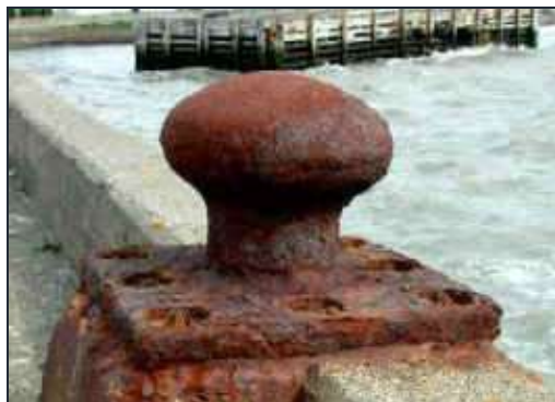
Slika 47. Primjer opće korozije [93]
