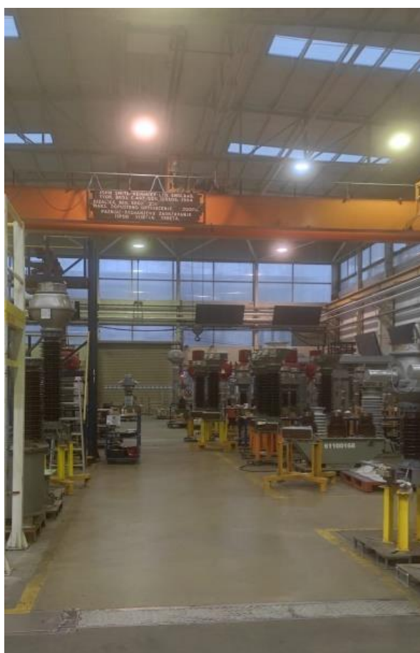
Slika 13: Kranska dizalica iz “KONČAR-Mjerni transformatori d.d.”
