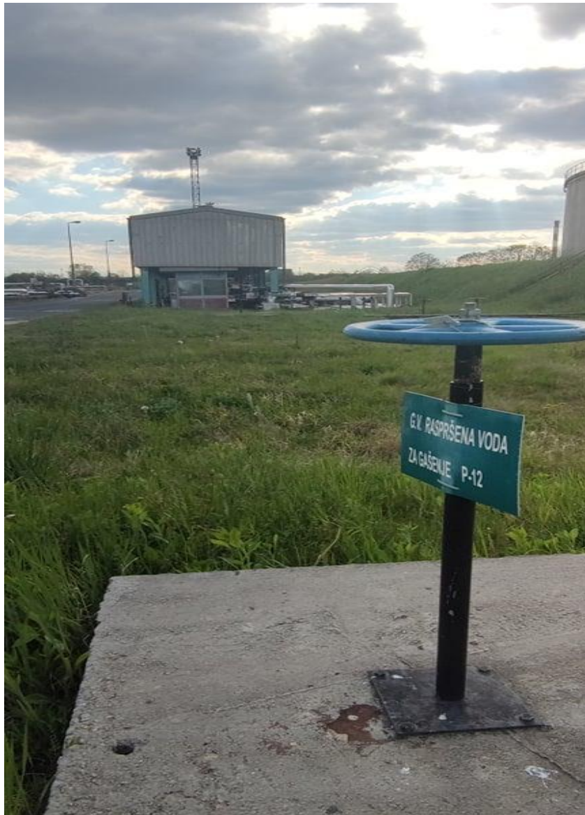
Slika 7. Sustav za hlađenje raspršenom vodom za pumpanu
