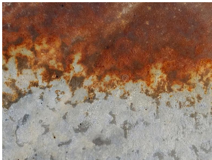
Slika 9. Prikaz atmosferske korozije [13]
