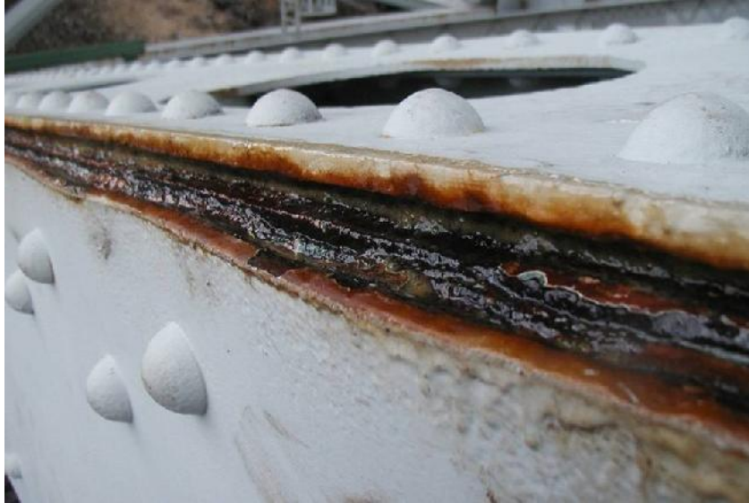
Slika 12. Primjer korozije u procjepu, spoj na konstrukciji [19]
