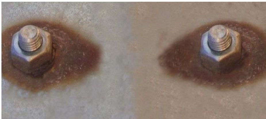
Slika 11. Primjer galvanske korozije, spoj vijka i matice [18]
