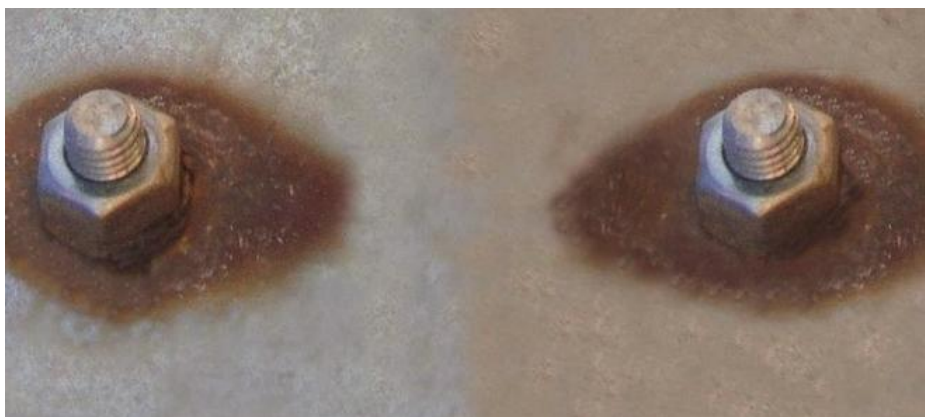
Slika 11. Primjer galvanske korozije, spoj vijka i matice [18]
