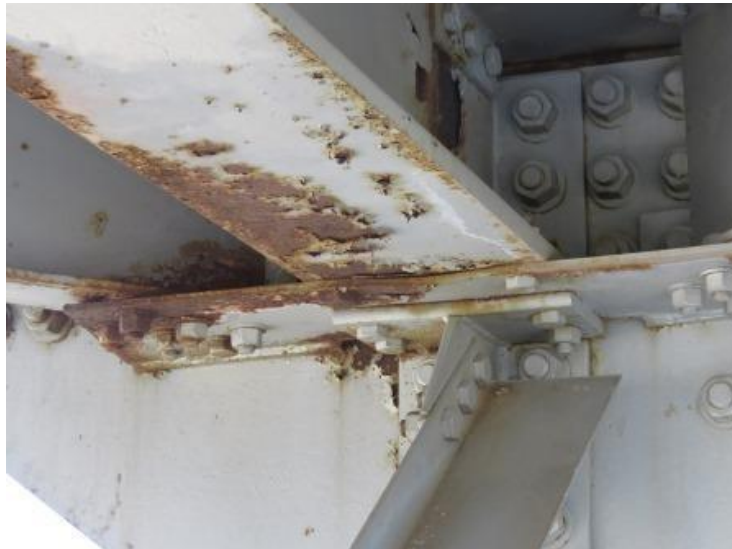
Slika 8. Primjer pjegaste korozije, spoj na mostu [16]
