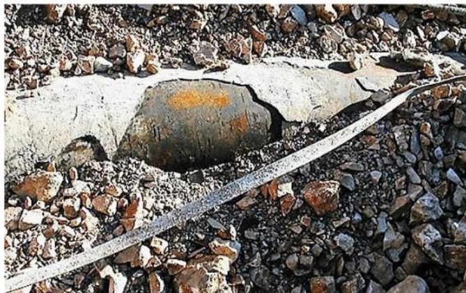
Slika 9. Korozija uslijed lutajućih struja na podzemnom spremniku [14]
