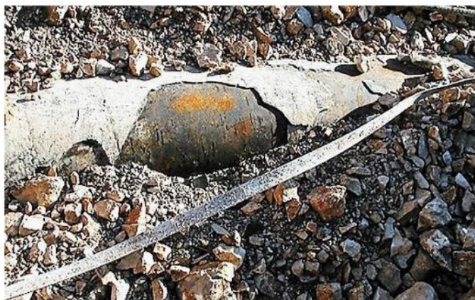
Slika 9. Korozija uslijed lutajućih struja na podzemnom spremniku [14]
