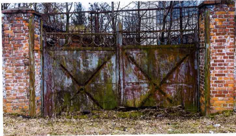
Slika 8. Primjer djelovanja atmosfertske korozije na ogradi [19]
