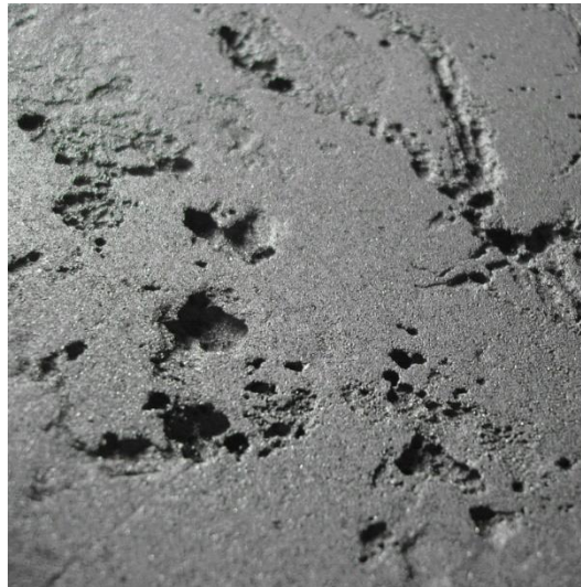
Slika 4. Primjer rupičaste korozije na stijenci kotla [9]
