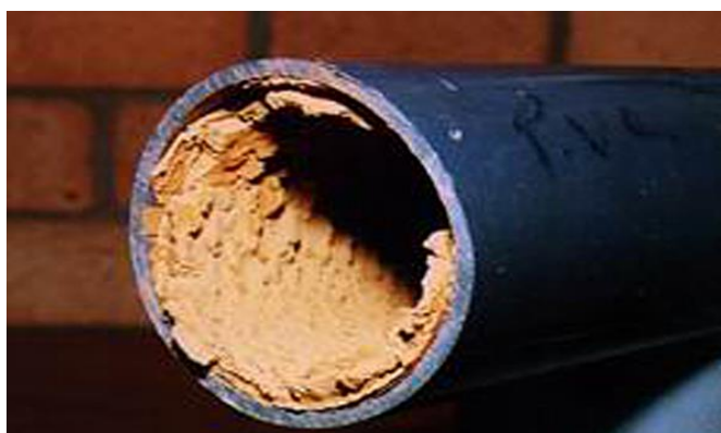
Slika 3. Cijev s nataloženim kamencem [11]
