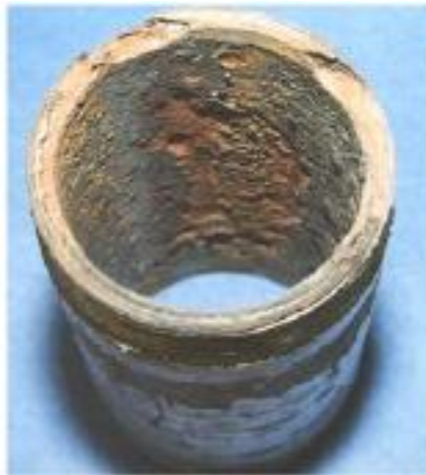
Slika 12. Primjer rupičaste korozije [13]
