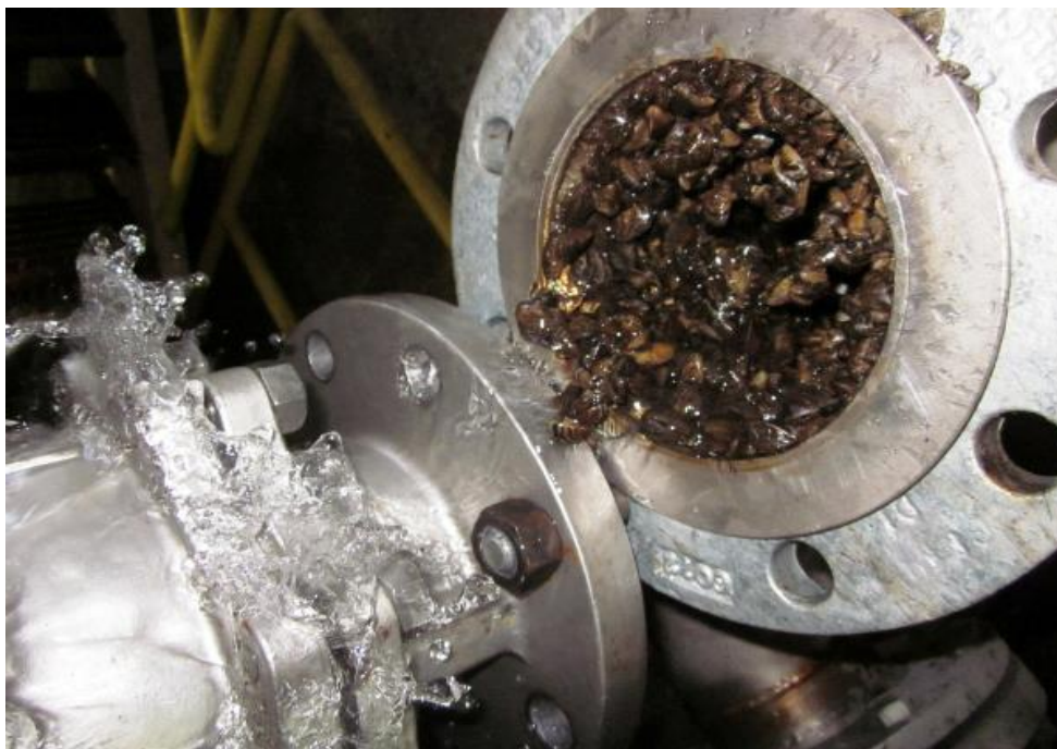
Slika 8. Začepljenje vodovodne cijevi uzrokovano raznolikom trokutnjačom 26
