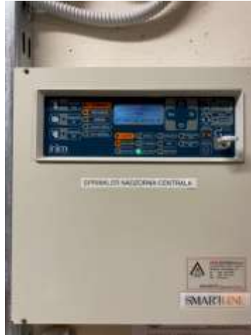
Slika 15. Sprinkler nadzorna centrala
