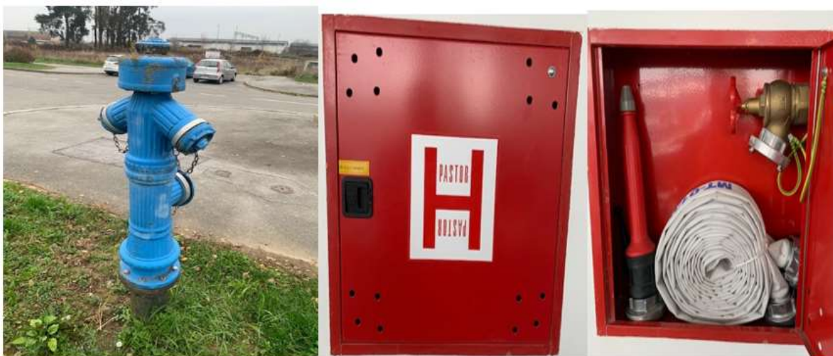
Slika 22. Unutarnji i vanjski hidrant
