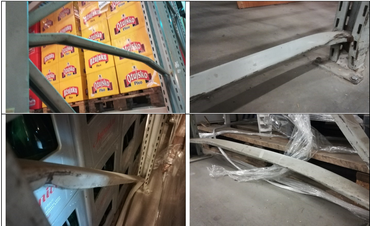
Slika 8. Oštećenje elementa za ukrućivanje [4]
