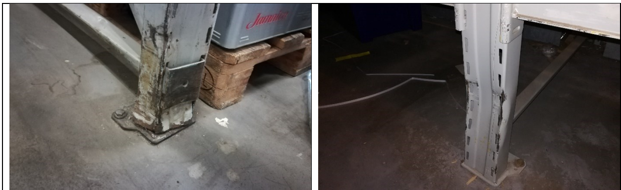
Slika 9. Oštećenje profila sprijeda [4]
