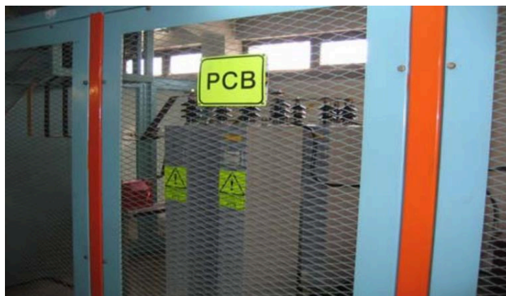
Slika 3. Označavanje električnog transformatora koji sadrži PCB [18].
