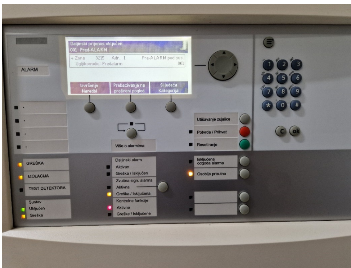
Slika 7. Digitalna nadogradnja javljača požara sa sustavima pre-alarma
