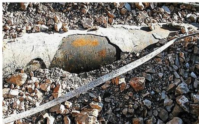
Slika 9. Korozija uslijed lutajućih struja na podzemnom spremniku [14]
