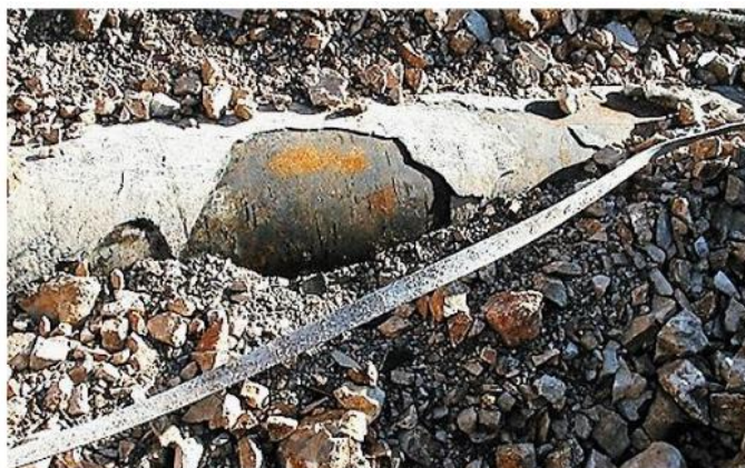
Slika 9. Korozija uslijed lutajućih struja na podzemnom spremniku [14]
