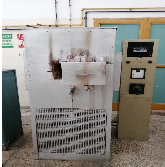
Slika 13. Fotografija elektrootporne komorne peći za žarenje.
