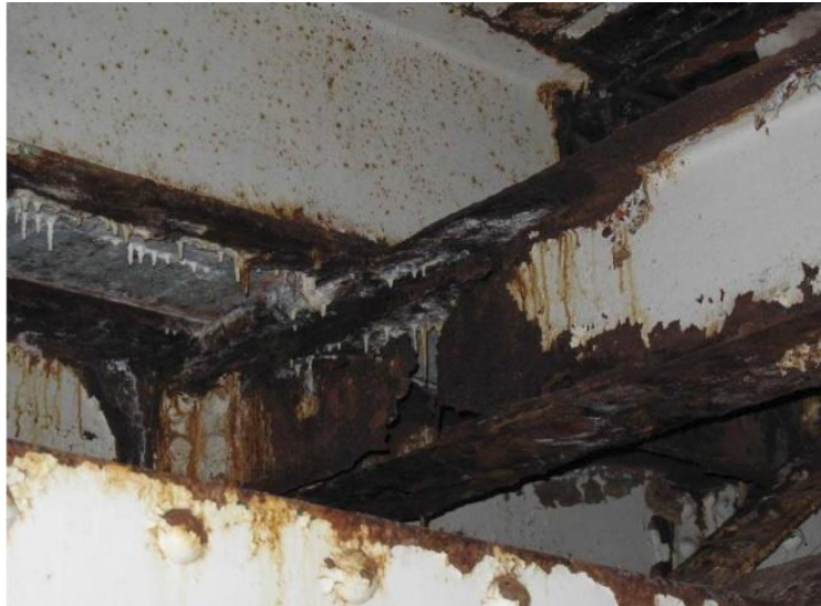
Slika 14. Korozija u procijepu čelične konstrukcije mosta [18]
