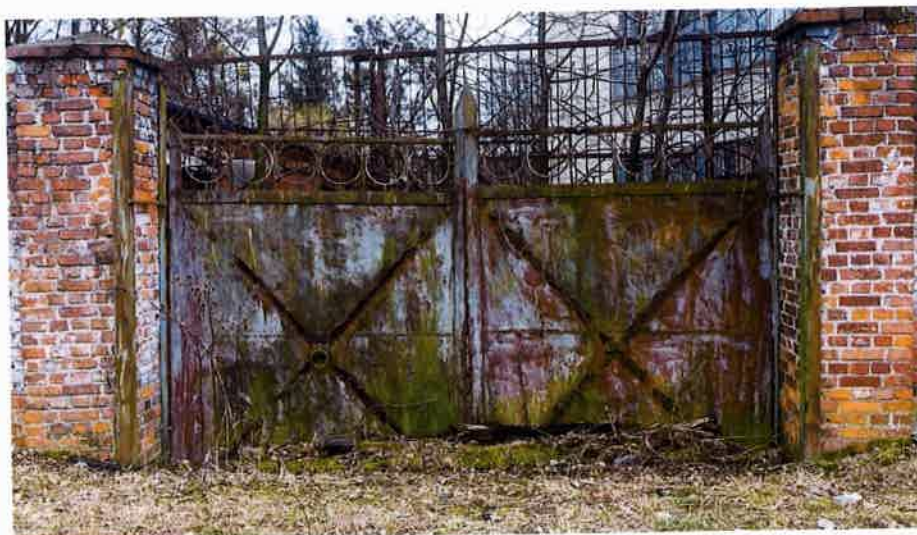
Slika 8. Primjer djelovanja atmosfertske korozije na ogradi [19]
