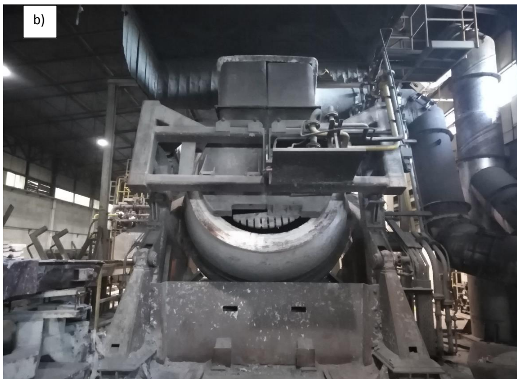
Slika 31. Rotacijska nagibna peć u tvornici CIAL d.o.o.: a) u radu, b) u hladnom pogonu
