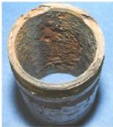
Slika 12. Primjer rupičaste korozije [13]
